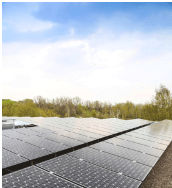
I pannelli solari HIT offrono un'eccellente resa per tetti con uno spazio limitato. PhCredit: Jörg Völker, AS Solar
